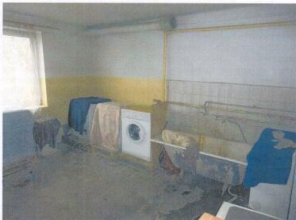
Zdjęcie 5 Pralnia w budynku komunalnym przy ul. Fabrycznej 2
