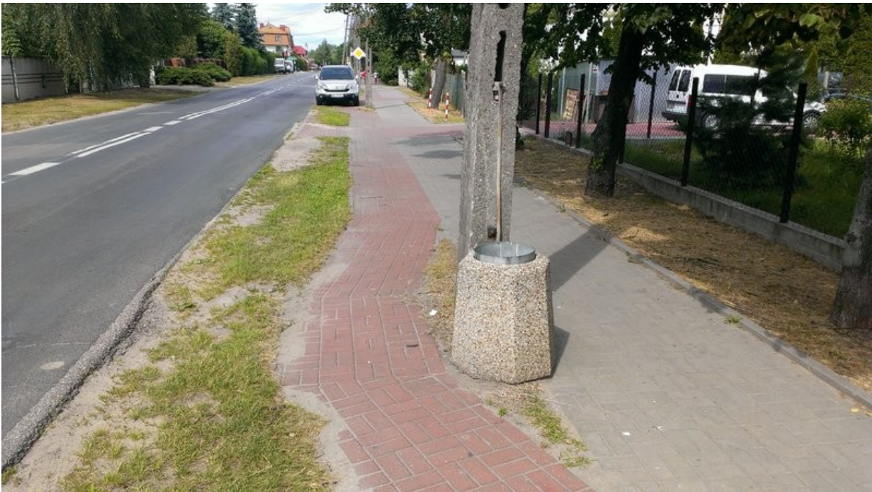
Ilustracja 46: Brak zachowanej skrajni poziomej oraz brak wyokrągłeń łuków, w tle samochód parkujący na DDR.
