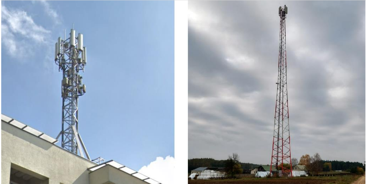
Rysunek 4. Stacje bazowe telefonii komórkowej na dachach budynków oraz wolnostojące
